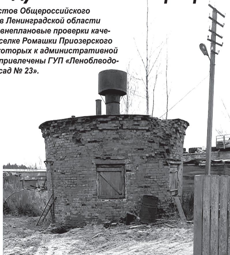
В таком плачевном состоянии находится здание очистных сооружений в пос. Ромашки. Жители сообщили, что они не работают уже более восьми лет.
