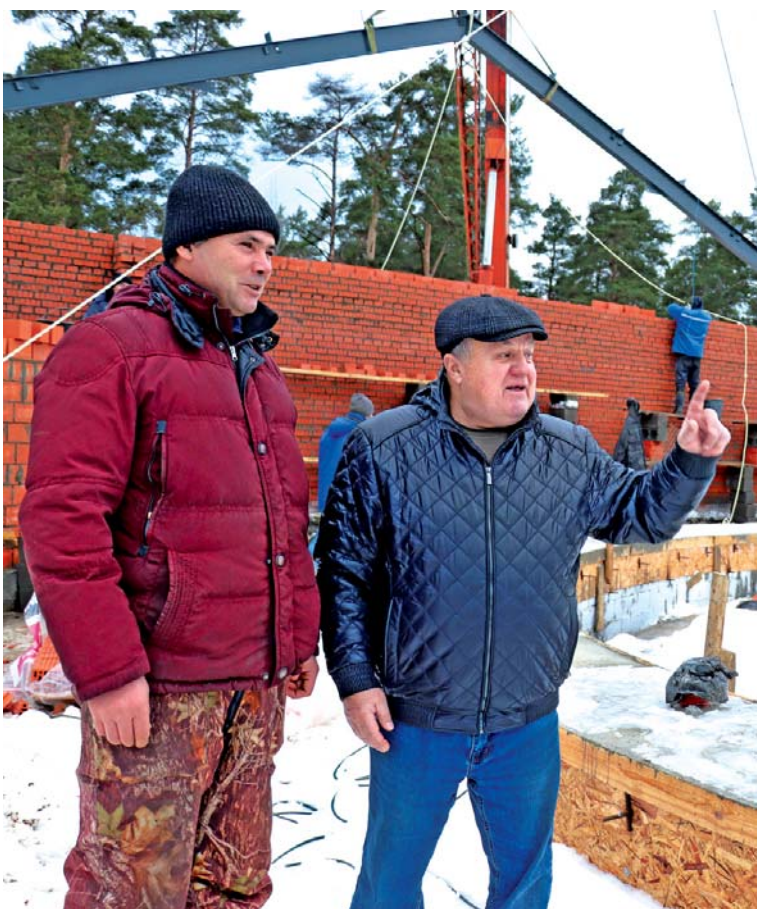
Леонид Одажиу (слева) и Михаил Рошак обсуждают ход работы строительства здания, где будет установлена доильная установка «Карусель».
