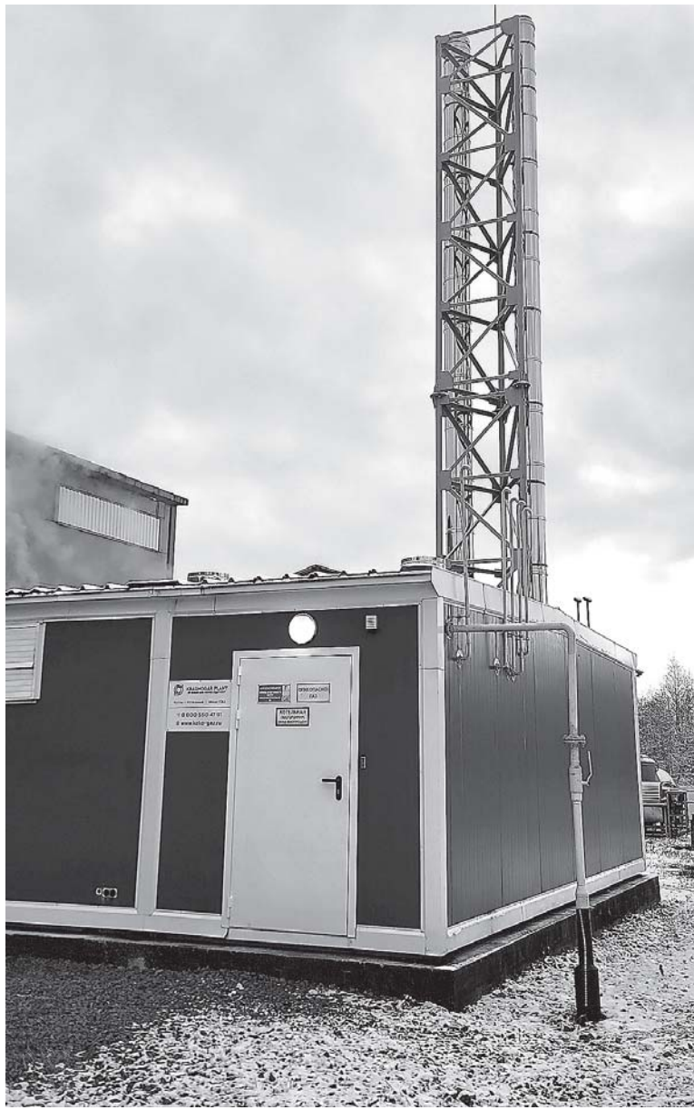
Новая газовая котельная.
